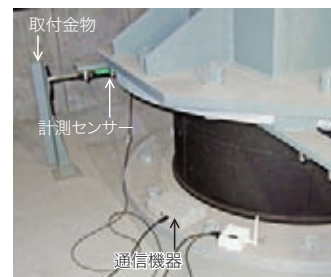
システム設置状況
