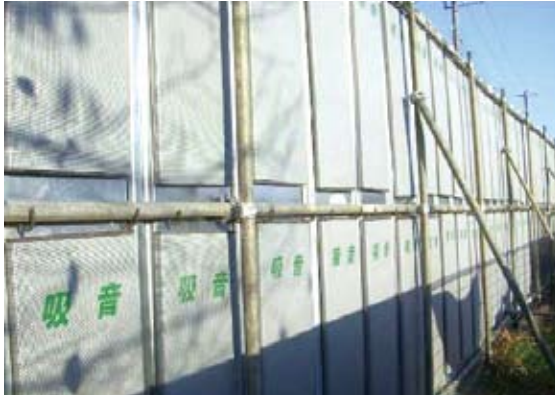
当社作業所仮囲いへの吸音パネル装着例
