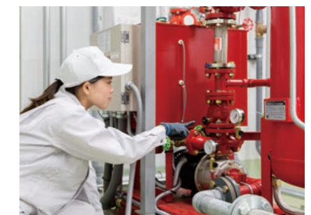
建築設備の日常点検
