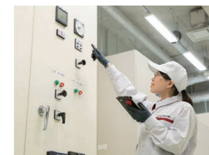
建築設備の日常点検
