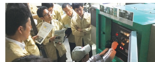
震災実動訓練(発電機稼働訓練)
