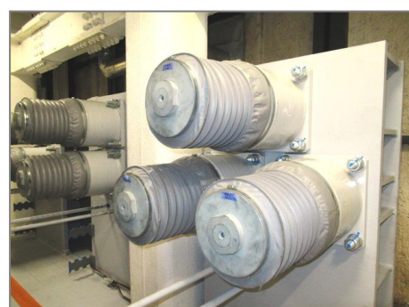
「オイルバッファ」設置写真
