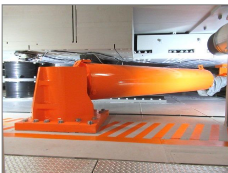
「オイルダンパー」設置写真
