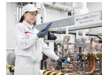
建築設備の日常点検
