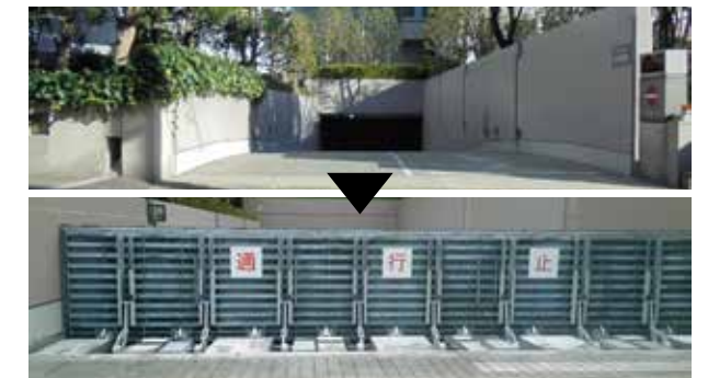
水害対策(起伏式防水板)の実施事例
