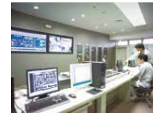
設備集中監視
