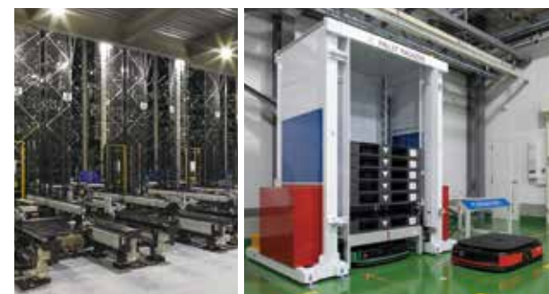
自動倉庫・搬送システム納入事例(左右とも)
