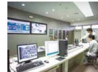
設備集中監視
