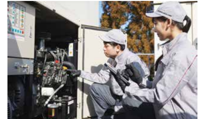
非常用発電設備点検
