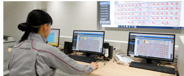
管理センターからのリモート監視・制御
