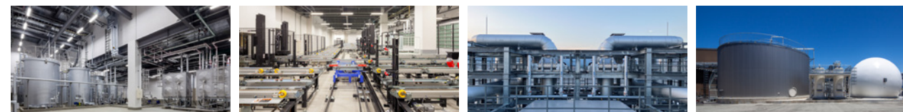
食油タンク室(食油供給設備) 出荷エリア(自動搬送設備) 屋上設備エリア(廃熱・排水回収設備) 環境設備エリア(メタン発酵設備)
