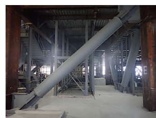
開発ダンパーの取付状況
