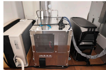
燃料電池システム
