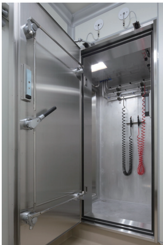
Photo 7 薬液シャワールーム Chemical shower room
