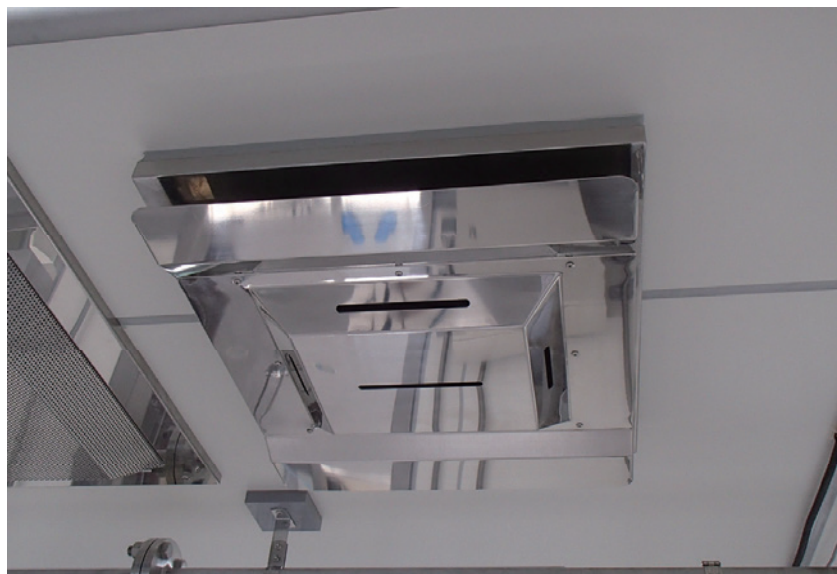
Photo 6 室内除染システム（薬剤噴霧装置天井据付型） Decontamination system
