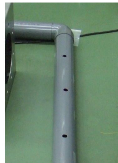
Photo 14 ノズル付きのダクト Duct with nozzle
