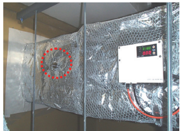
Photo 10 ダクト点検口 Inspection port
